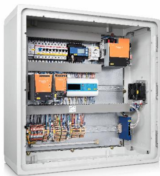
Fig. 1: Esempio dell'interno di un quadro. L'interno e la struttura del quadro dipendono dalla variante selezionata.
